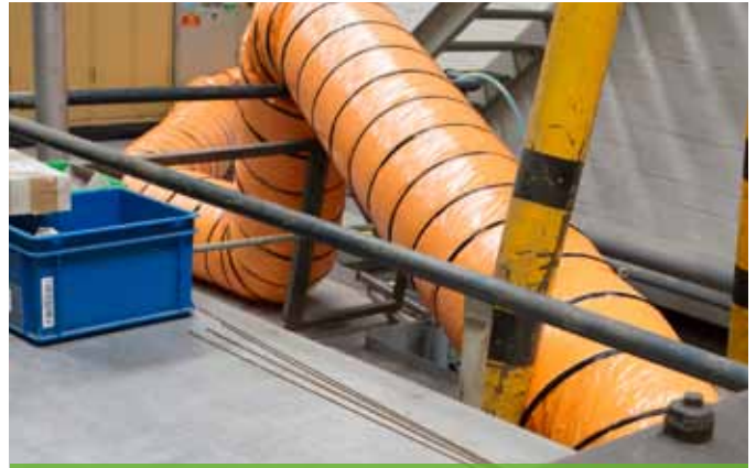
Ein Schlauchsystem sorgt für den permanenten Luftaustausch in der geschlossenen Einhausung.
