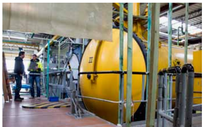
Halle von Premium AEROTEC in Nordenham – hier befinden sich gleich mehrere Autoklaven – einer davon wurde nun saniert.
