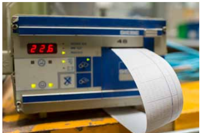
Ein Druckmessgerät überwacht den nötigen Unterdruck.
